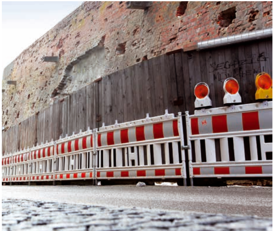
Die Sanierung der momentan arg ramponierten Mauer wird noch bis Mai dauern.
