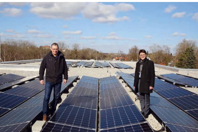
Auf zahlreichen städtischen Gebäuden erzeugen Photovoltaikanlagen grünen und günstigen Strom, wie hier auf dem Dach der Mittelschule Dachau-Süd (OB Florian Hartmann (r.) und der Klimaschutzbeauftragte Dr. André Suck).
