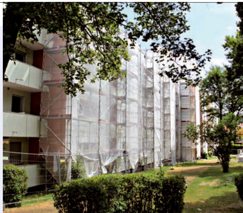
Weniger Heizkosten für 44 Mieter: Das Wohngebäude der Stadtbau GmbH Dachau in der Indersdorfer Straße wird gerade saniert.
